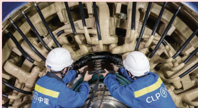
薄型的机器人配备了相应的设计和机械装置，使其能够“爬过”挡板并自动完成检查。
