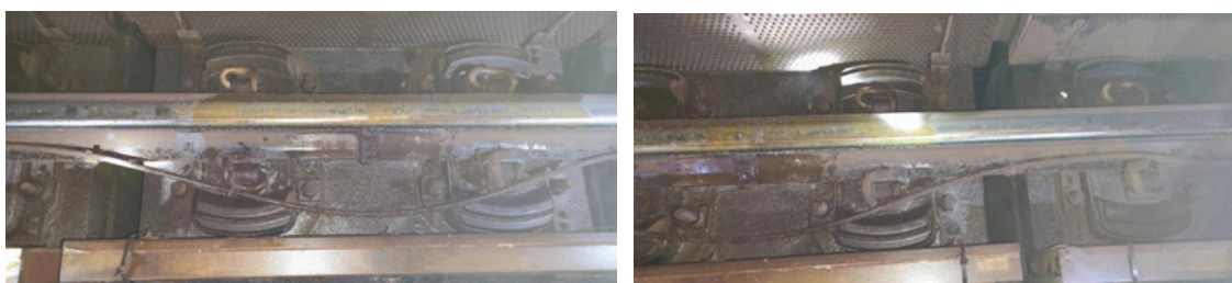
图 2.2 路轨表面状况及喷油痕迹
